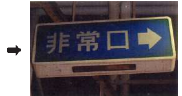
10年経過し劣化したパネル
