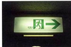
正常なパネル
